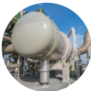
RECIPIENTES A PRESIÓN Y CALDERAS
